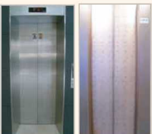
오티스, 티센크루프 - Elevator
