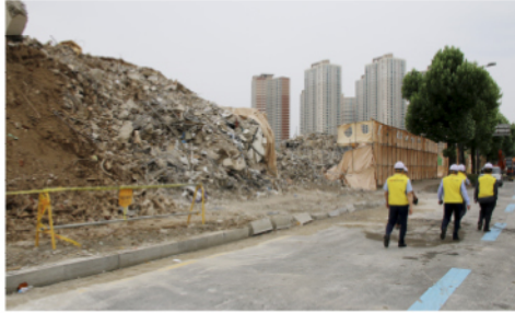
〈동구 학동 건축물 해체공사 중 붕괴사고 발생 현장〉
