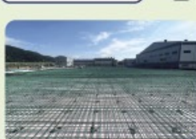
연약지반 (주)파나시아 공장
